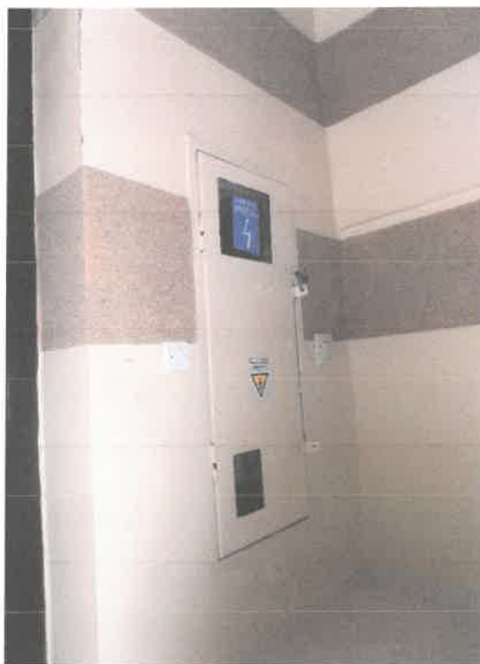
Fot. nr 1.2. Widok na wejście do klatki schodowej i główne złącze elektryczne budynku, oraz główny wyłącznik prądu
